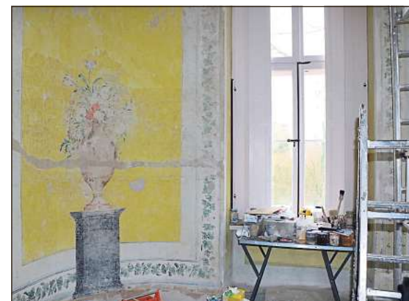
In den nächsten Wochen soll auch das gelbe Kabinett im Herrenhaus fertiggestellt sein.
